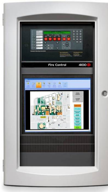
Illustration 1: Système de commandement en cas d'incident TrueSite installé dans la baie 2 d'un panneau de contrôle 4100ES (illustré avec le contrôleur central)
